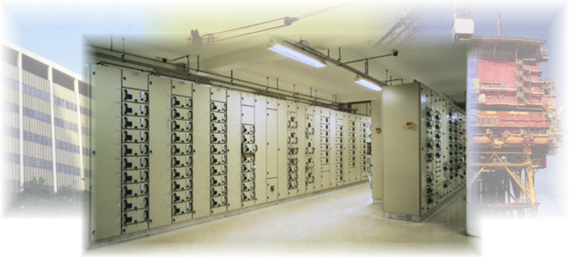
Motor Control Centre, Draw-out Power Station, Skærbækværket, Denmark
